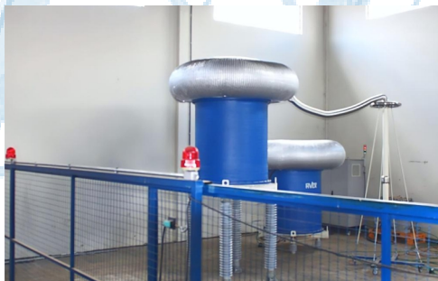
LABORATÓRIO DE TENSÃO APLICADA Laboratorio de Tensión Aplicada
