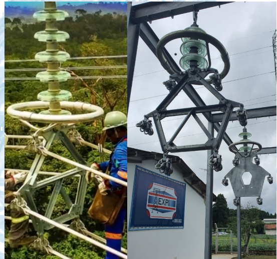
FERRAGENS PROJETO XRTE 800 kVDC Herrajes Proyecto XRTE 800kV DC
