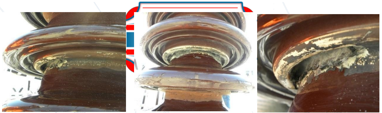
Figura 11 – Fotos do descolamento ocorrido em isoladores multicorpo 345 kV. [1]
