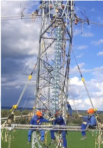
CADEIA COMPLETA EM GRAMPEAMENTO PROJETO PRTE 500 kV Cadena completa en grapado Proyecto PRTE 500 kV
