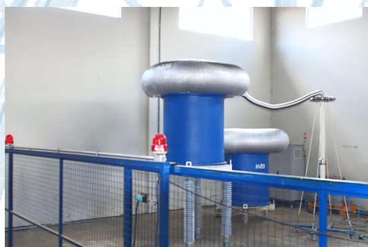
LABORATÓRIO DE TENSÃO APLICADA Laboratorio de Tensión Aplicada
