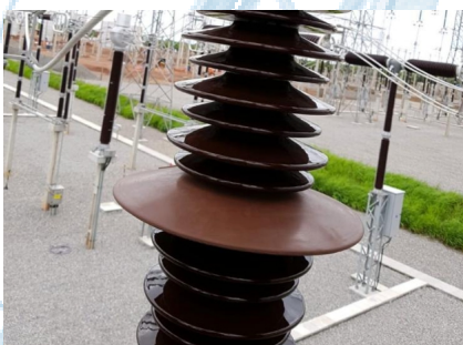
BOOSTER SHED HTV INSTALADO EM SE 500 kV Booster Shed HTV instalado en subestación 500 kV
