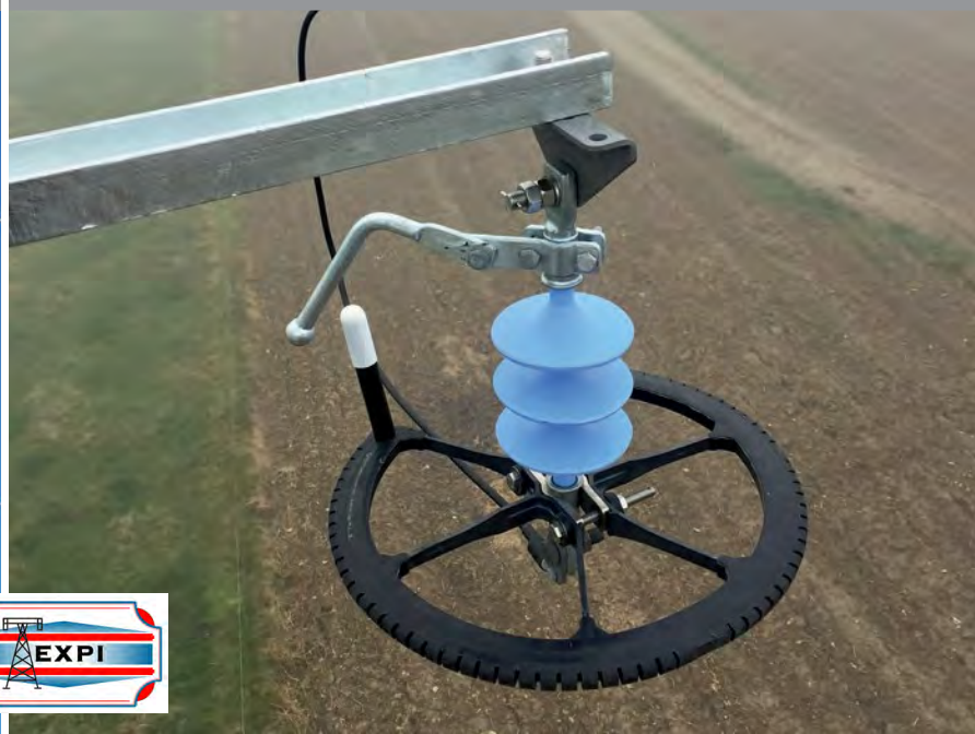
LLPD instalado na Suíça
